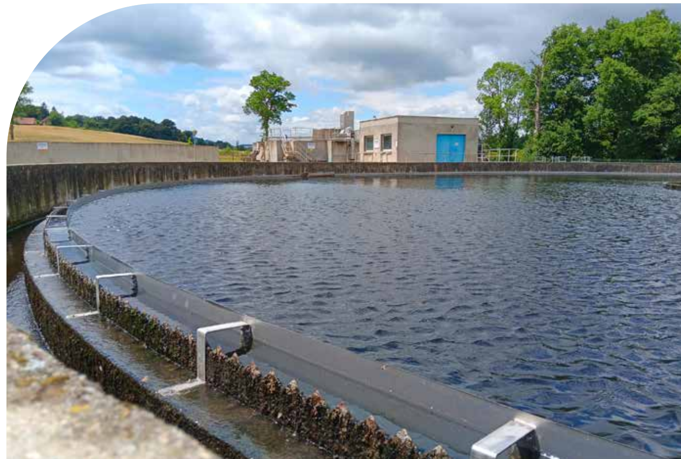
Station d'épuration de Guéret
