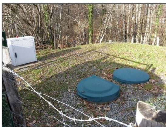
Photo 1 : Poste de refoulement route de la Brionne
