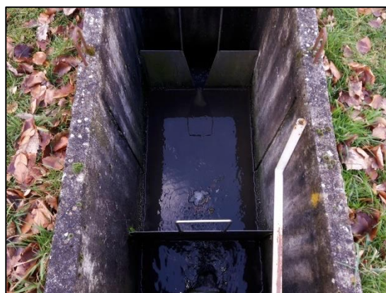
Photo 3 : Canal de comptage
